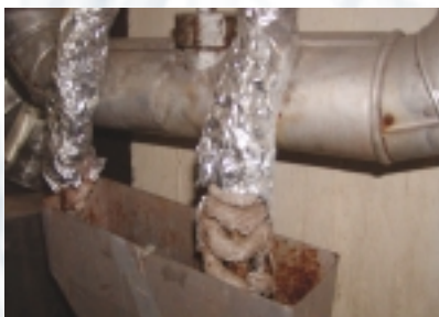
Asbeszt szigetelés csöveken
